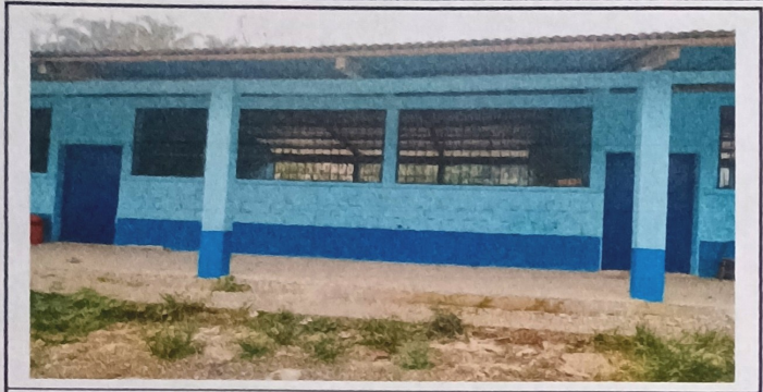
Foto 1: fase de final del mantenimiento, instalacion de puertas, balcones y pintadas de la pared del modulo I.
